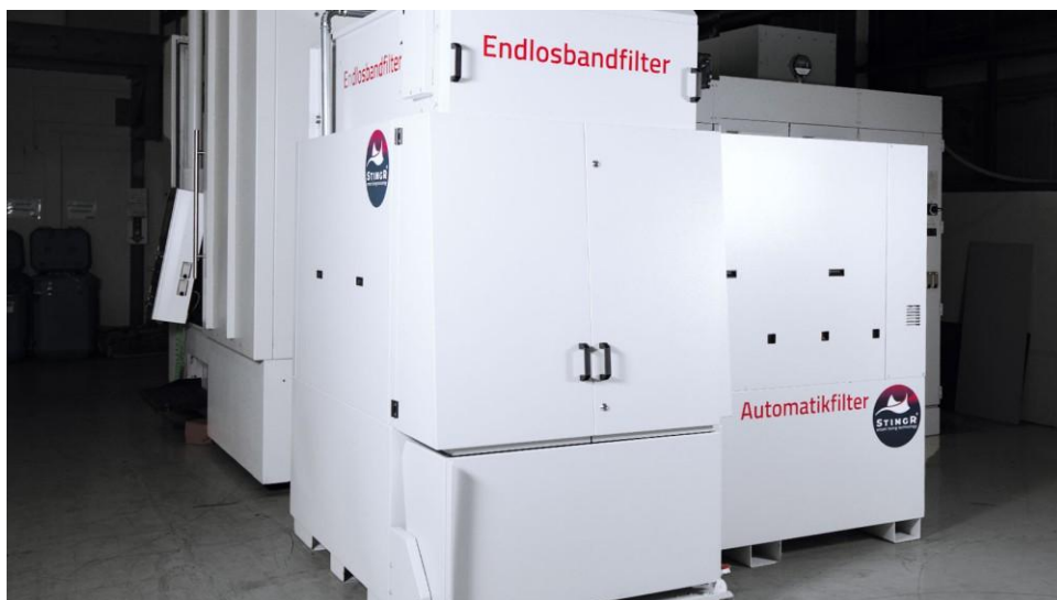
Installation en service chez le client
